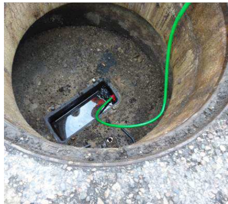
Figure 11 : Amont du séparateur à hydrocarbures, entreprise 1. Source : CNIDEP
