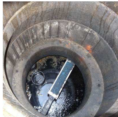
Figure 12 : Aval du séparateur à hydrocarbures, entreprise 1. Source : CNIDEP
