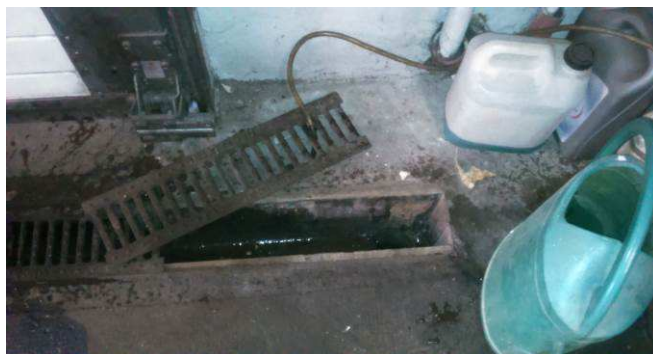
Figure 23 : Rigole de collecte encombrée entreprise 2, phase démonstrateur. Source : CNIDEP
