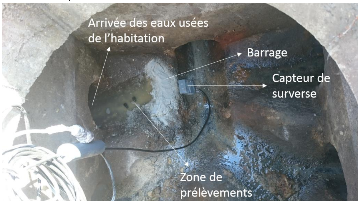
Figure 11. Dispositif expérimental mis en place dans le réseau d'assainissement
