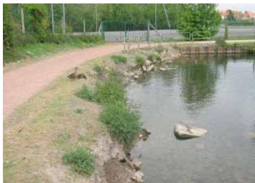
Erosion et dégradation des berges au niveau de la zone de retournement sur la Scarpe. Automne 2010
