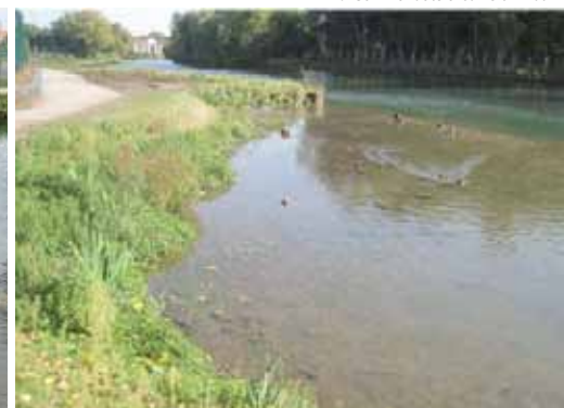
Retalutage des berges et création d'une roselière par fermeture de la zone de retournement. Automne 2012
