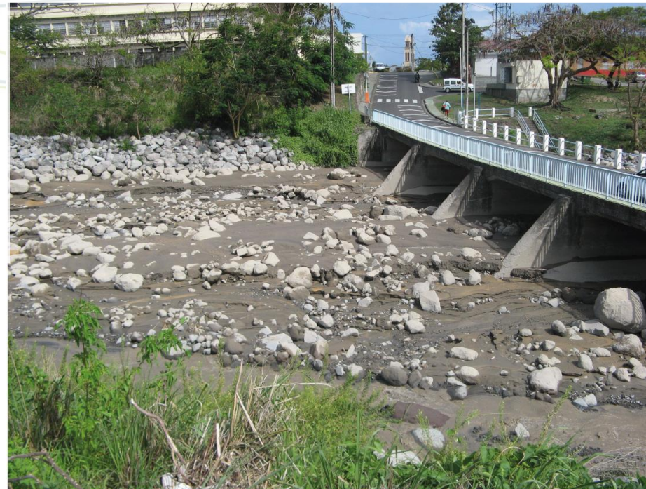
Vue du pont du Prêcheur après le lahar du 17 mai 2010
