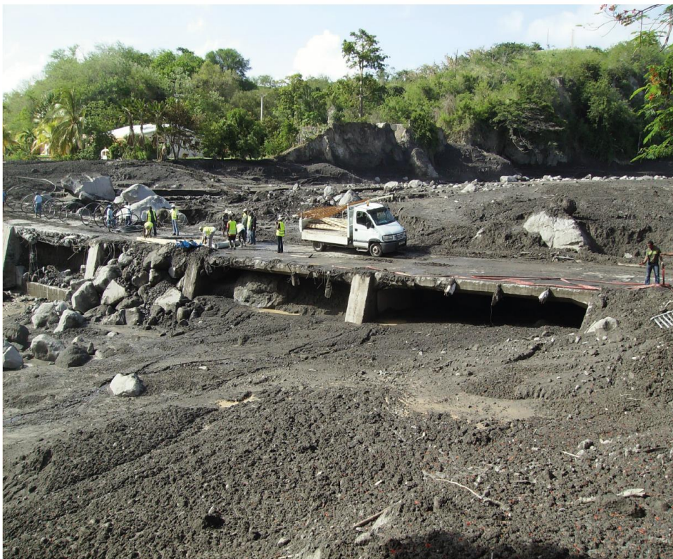
Vue du pont du Prêcheur après le lahar du 19 juin 2010 (cliché: DEAL Martinique, 21/06/2010)
