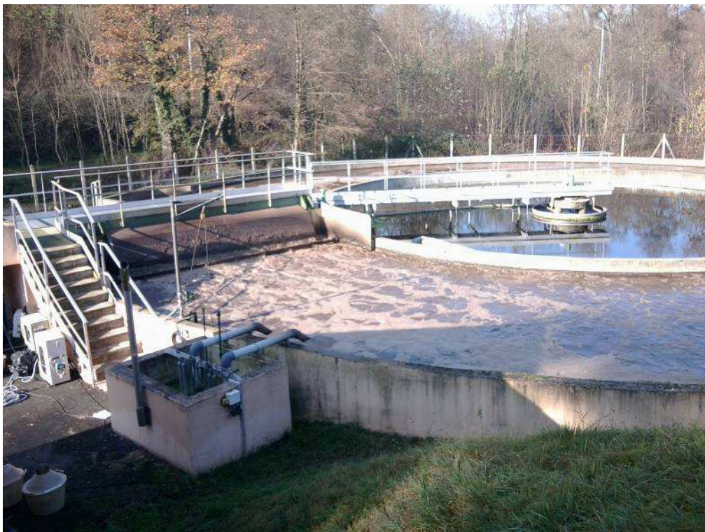
Figure 2 : Photographie de la STEU étudiée (site Dw)
