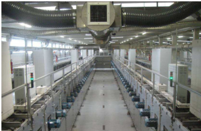
Figure 18 : Deux sécheurs basse température – marque STC
