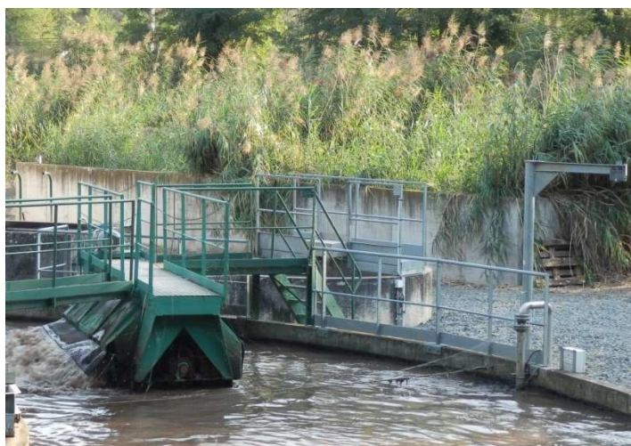
Figure 30 : Lit de séchage de boues planté de roseaux et bassin d'aération de la file eau (premier plan) du site Hs
