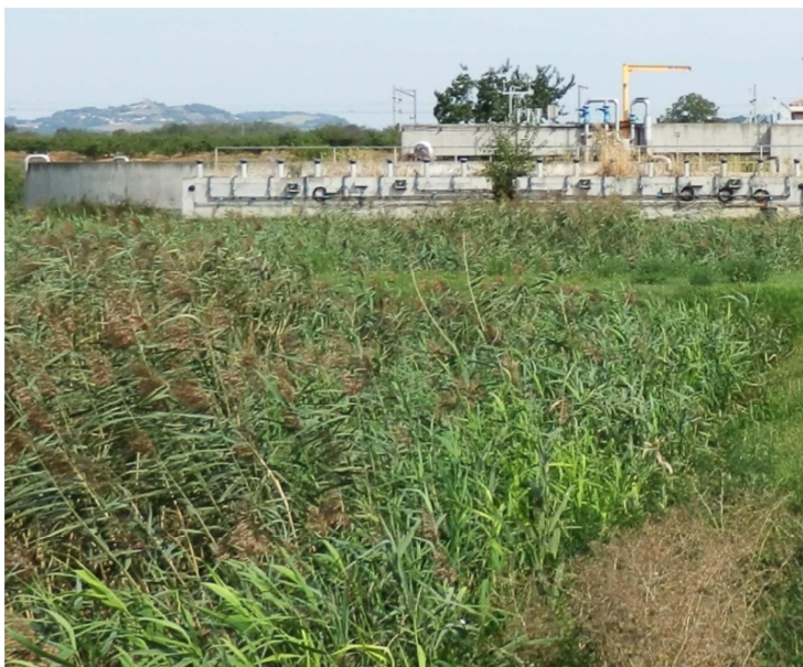
Figure 33 : Lit de séchage de boues planté de roseaux et bassin d'aération de la file eau (arrière-plan) du site Is
