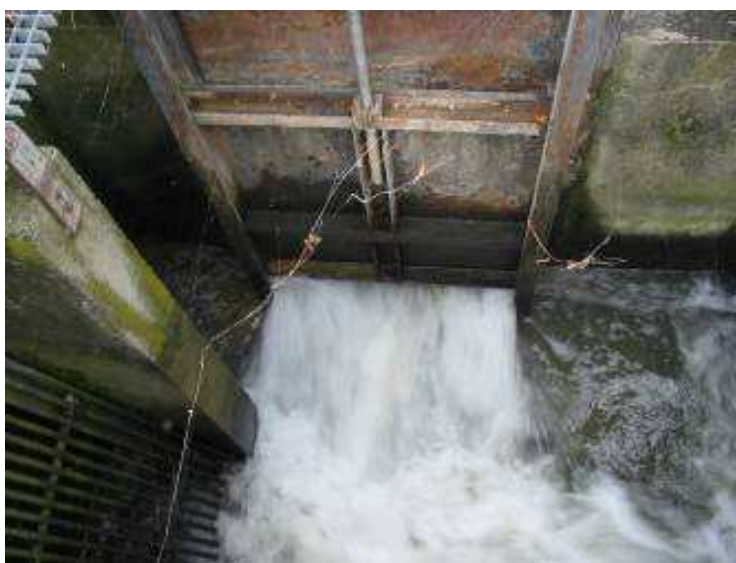
Figure 14 : Exemple d'écoulement sous une vanne de fond
