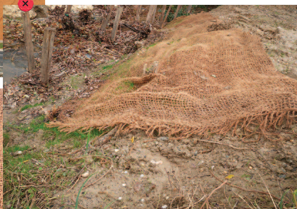
Ancrage insuffisant du filet en amont.
