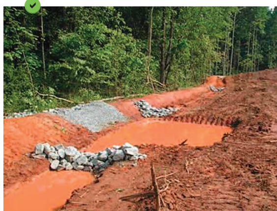
Piège à sédiments positionné en bas de pente avec fosse de récupération des écoulements.
