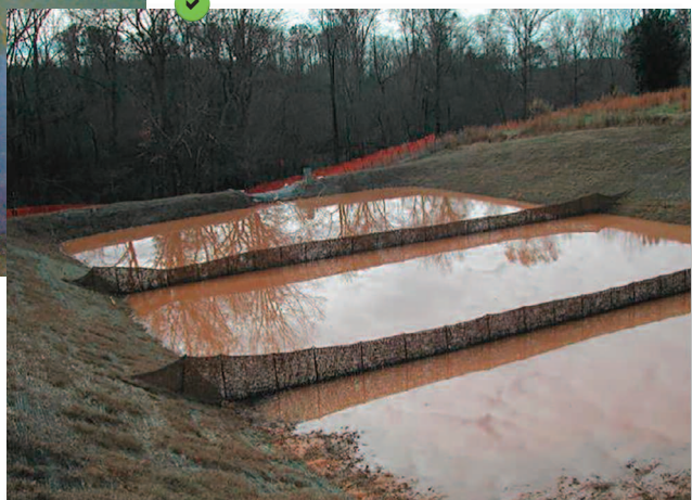
Bassin de décantation aux berges végétalisées et équipé de barrières perméables en toile coco.
