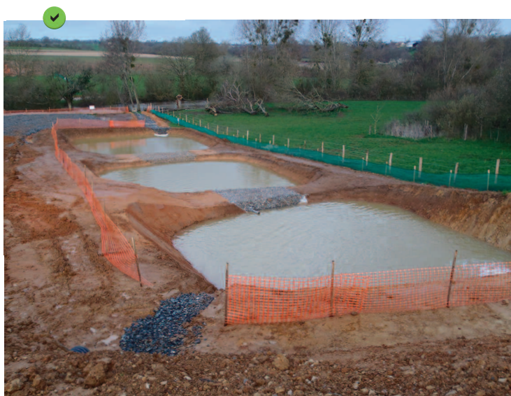
Bassin de décantation constitué de trois sous bassins successifs.
