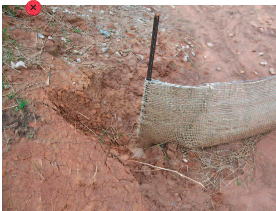
La mauvaise disposition des barrières entraîne des contournements et des processus d'érosion des talus.
