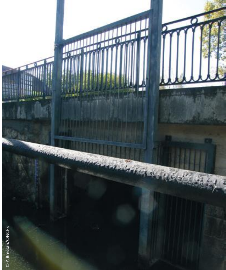
▲ Dans le cas d'un système anti-remontée, la hauteur de la grille doit être suffisante pour empêcher son franchissement par un castor même en cas de crue.
