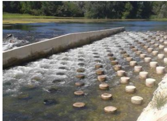
Rampe à macro-rugosités (© pôle échohydraulique, OFB)
