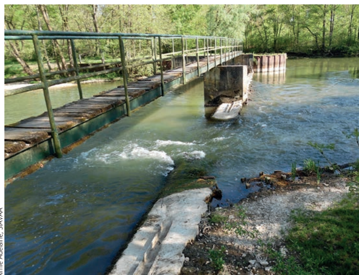
L'ouvrage de Roussy amont en juin 2015, après la création de brèches dans l'ouvrage en béton.
